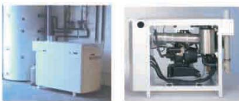
Slika 3. Mikrokogeneracijsko postrojenje s plinskim motorom
