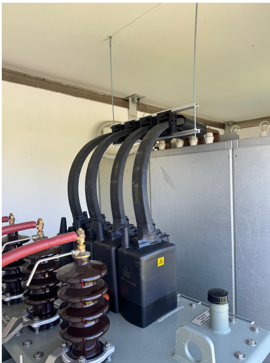
Slika 35. Spoj Flexbus sabirnica na niskonaponski sklopni blok - dovršen priključak
