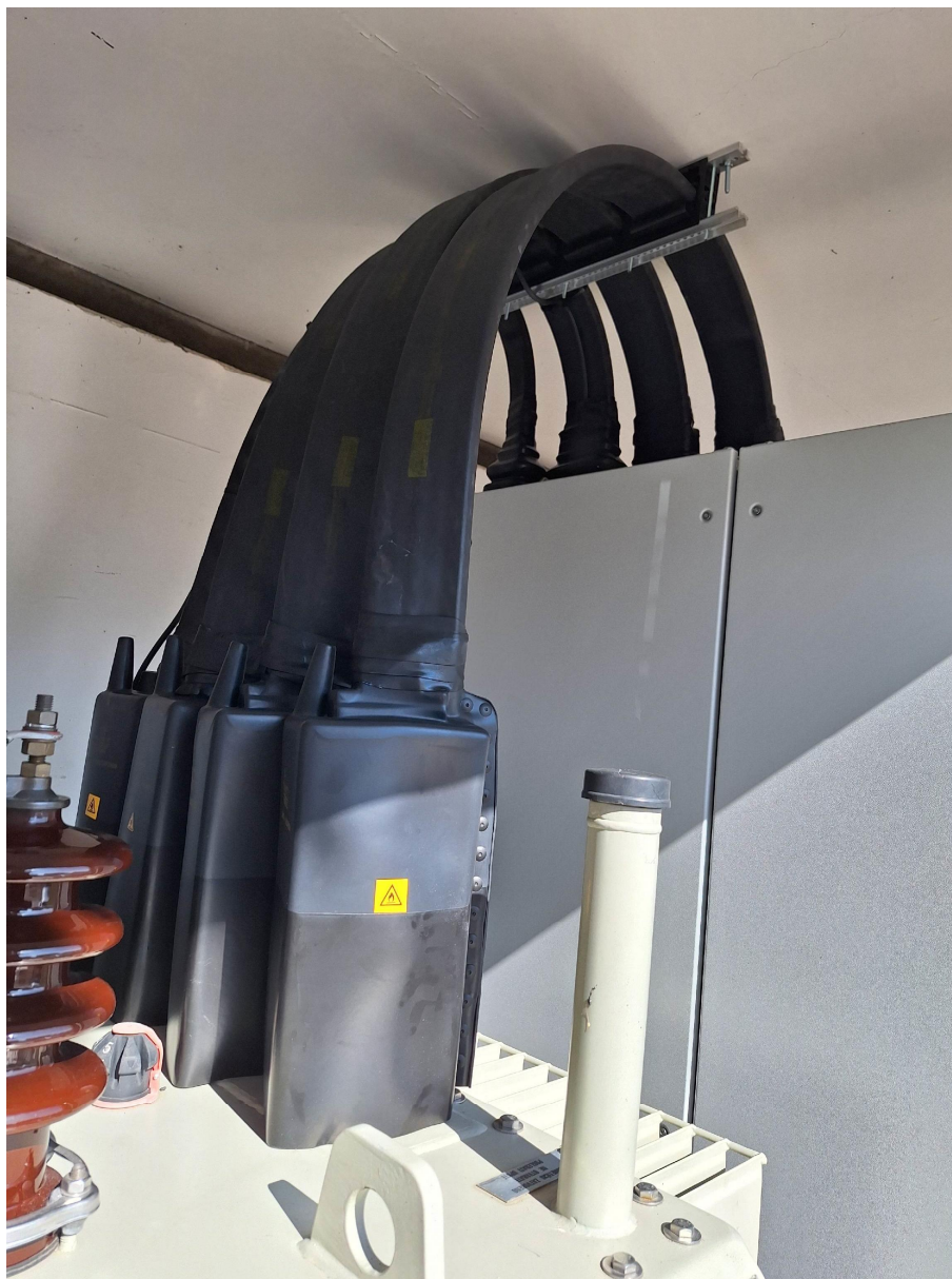
Slika 34. Spoj Flexbus sabirnica na niskonaponski sklopni blok - dovršen priključak
