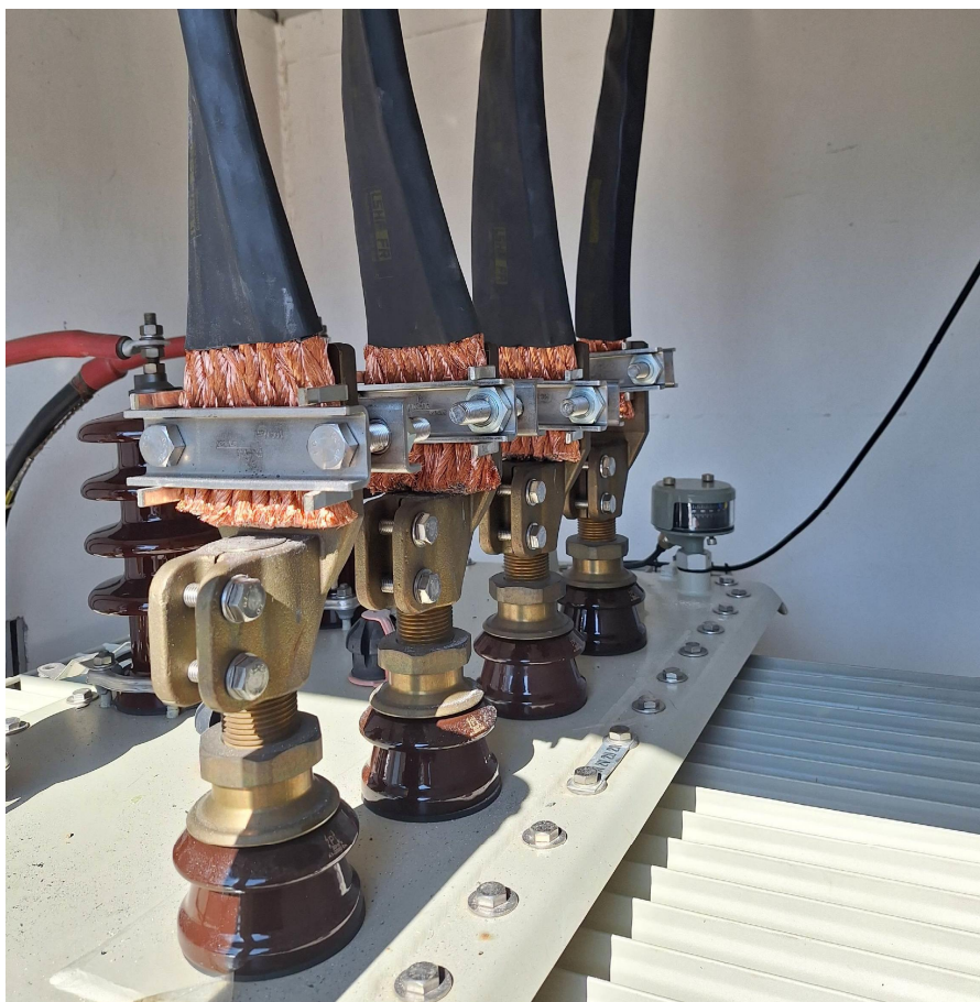
Slika 31. Spoj Flexbus sabirnica na uljni energetske transformator 1000 kVA
