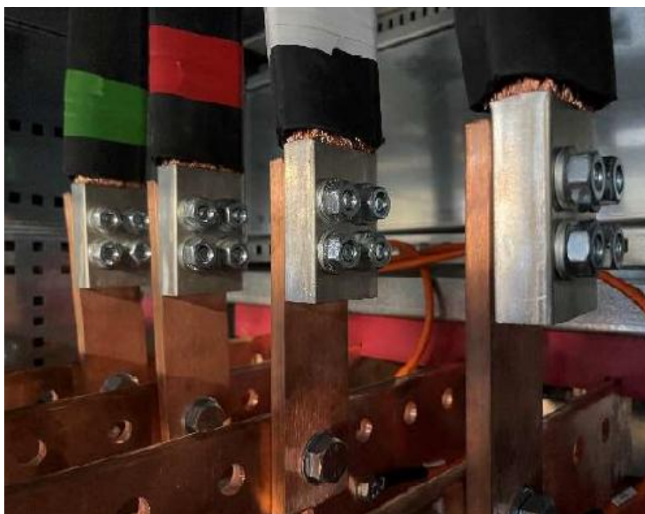
Slika 29. Spoj sustava izoliranih fleksibilnih sabirnica u niskonaponskom razdjelniku
