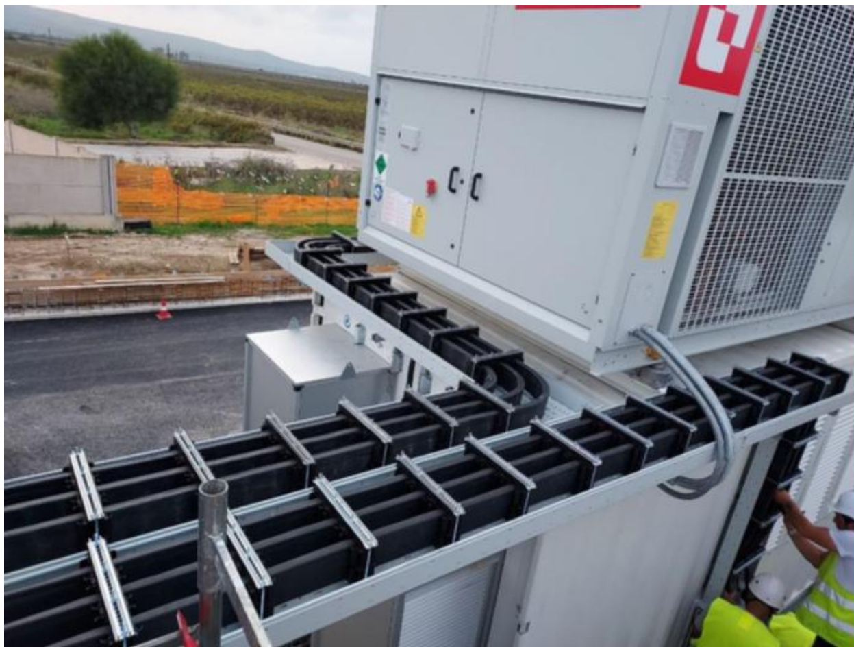
Slika 26. Primjer povezivanja generatora sustavom izoliranih fleksibilnih sabirnica, vanjska instalacija
