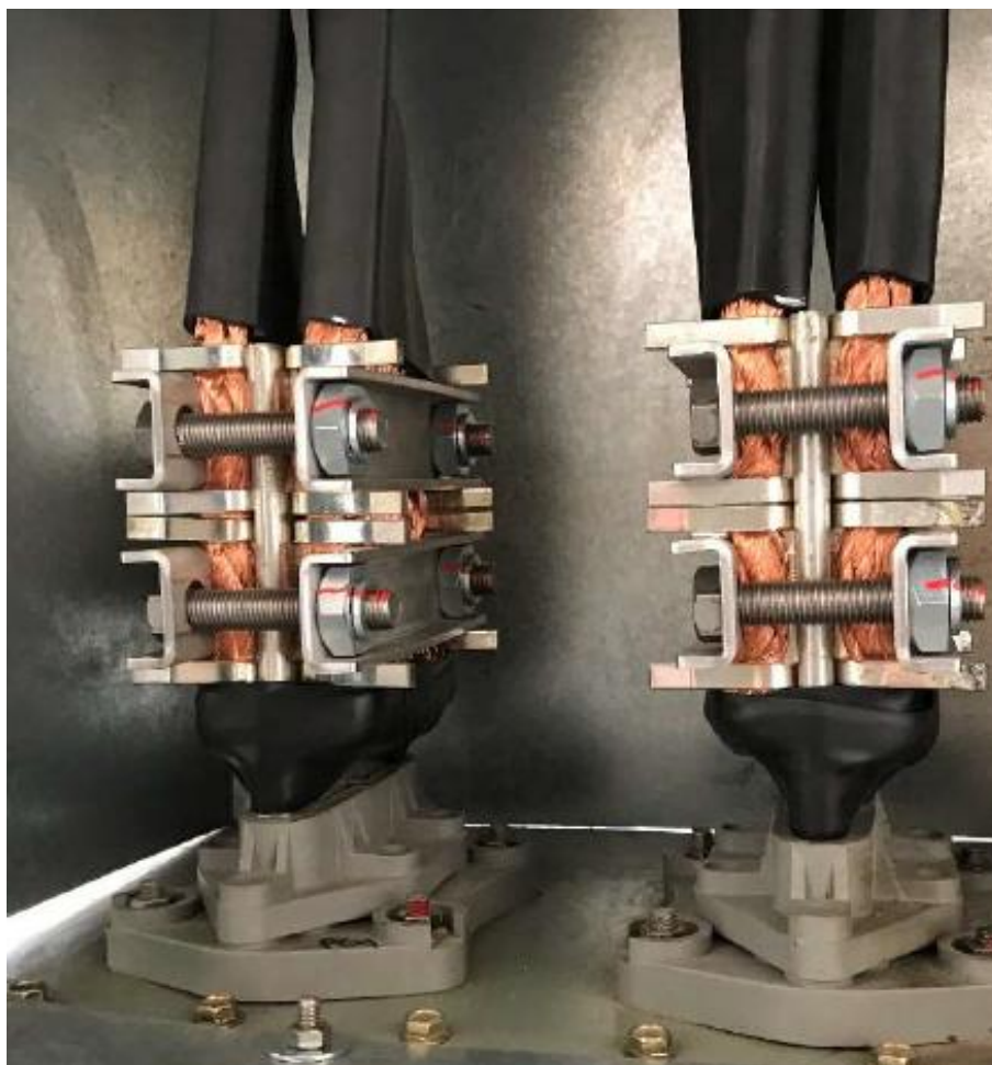
Slika 28. Spoj sustava izoliranih fleksibilnih sabirnica na transformator
