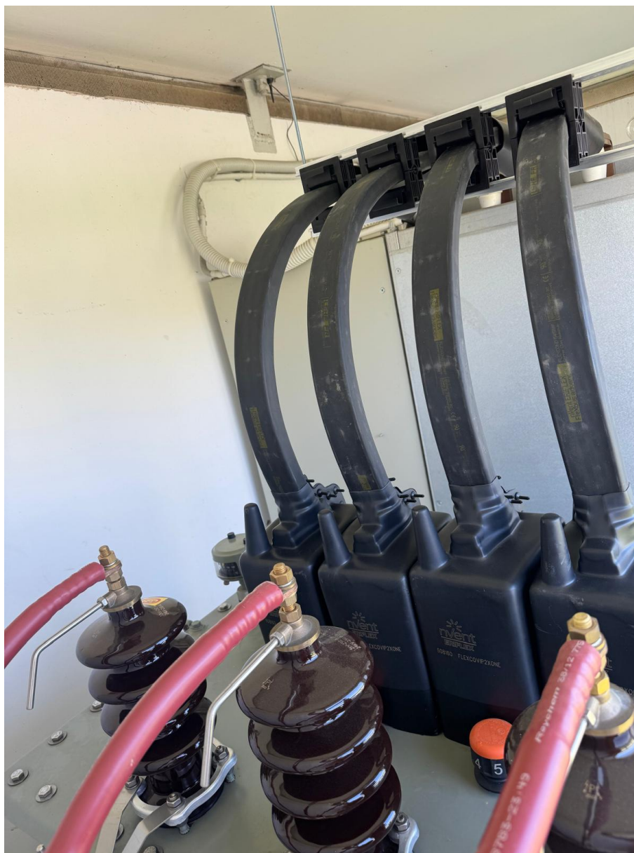
Slika 36. Spoj Flexbus sabirnica na niskonaponski sklopni blok - dovršen priključak
