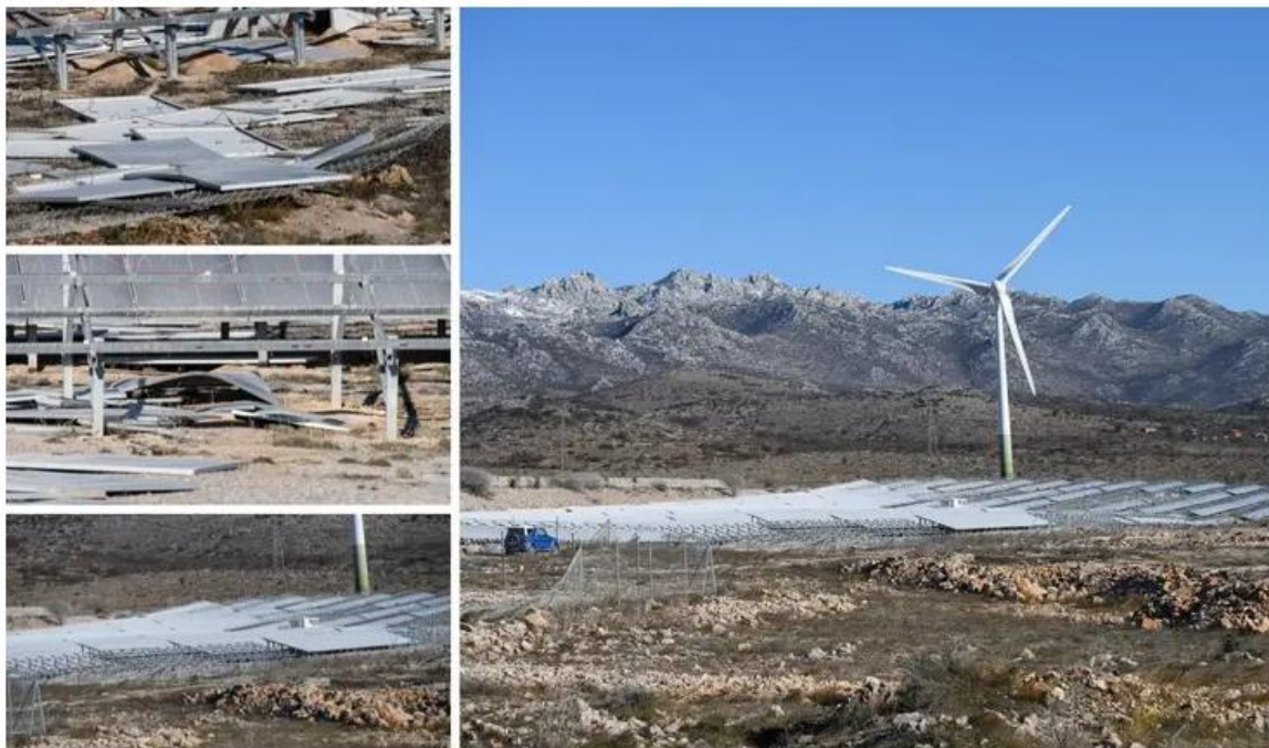
Slika 12. Slike uništene elektrane[4]
