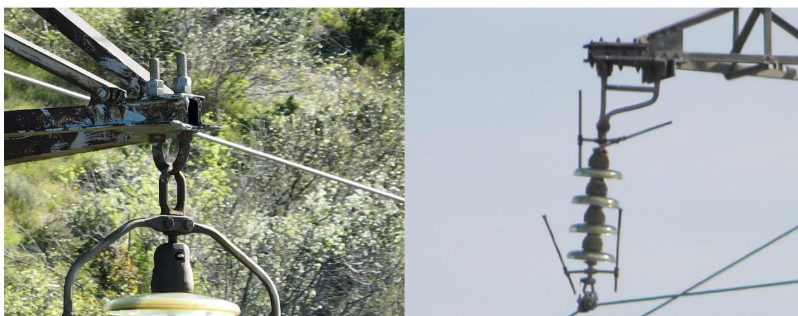
Slika 2: Primjeri oštećenja izolatorskih lanaca
