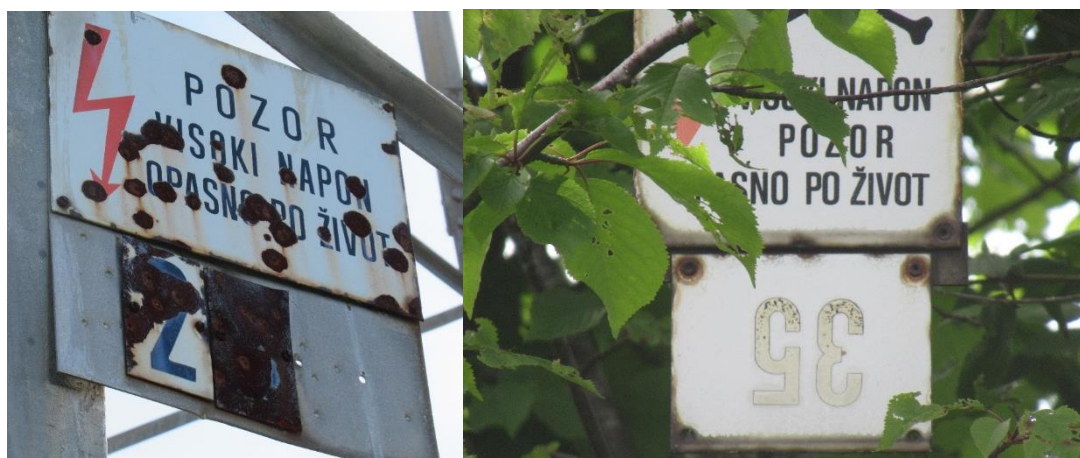
Slika 5: Primjeri oštećenja pločica za označavanje stupova
