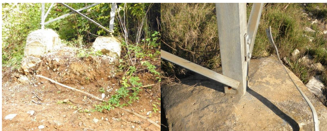
Slika 4: Primjeri oštećenja uzemljenja
