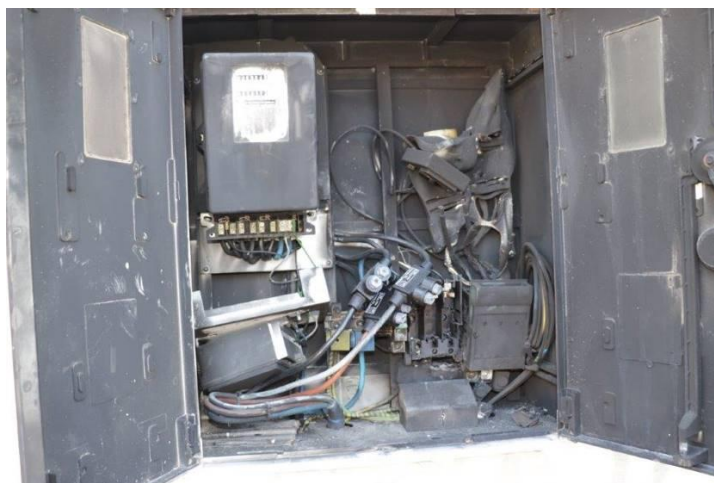
Slika 5: kućni priključni ormarić nakon prvog požara
