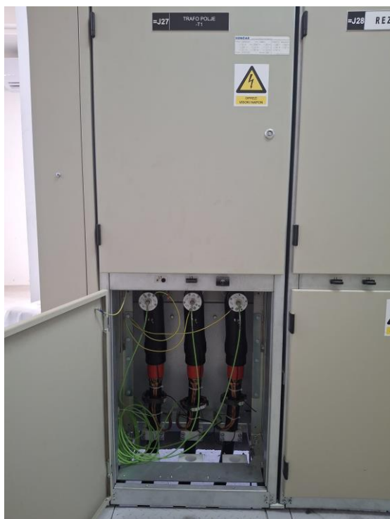
Slika 3.: Senzori u 20kV polju transformatora
