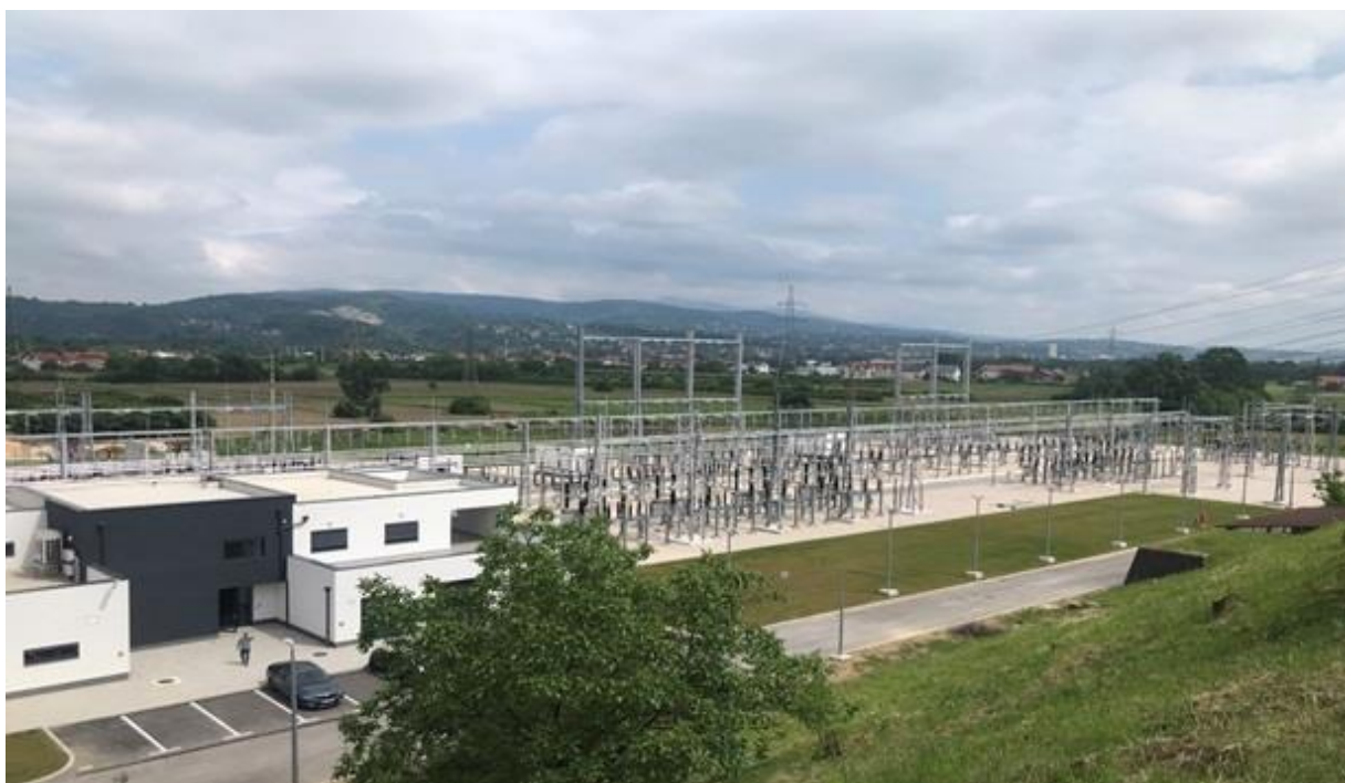
Slika1.: Izgled 110kV rasklopnog postrojenja nakon rekonstrukcije
