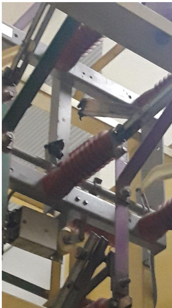
Slika 6. Kvar na izlaznom rastavljaču 35 kV vodnog polja u TS 35/10 kV Bulinac
