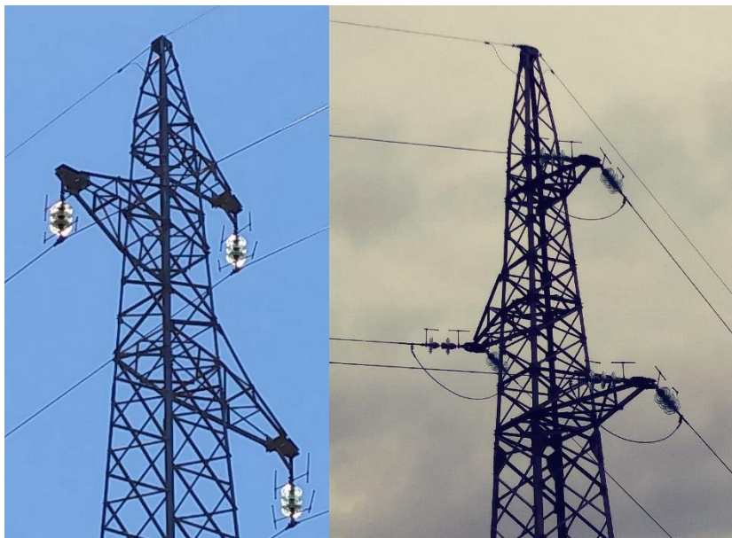
Slika 8. Problematični izolatorski lanci s iskrištima
