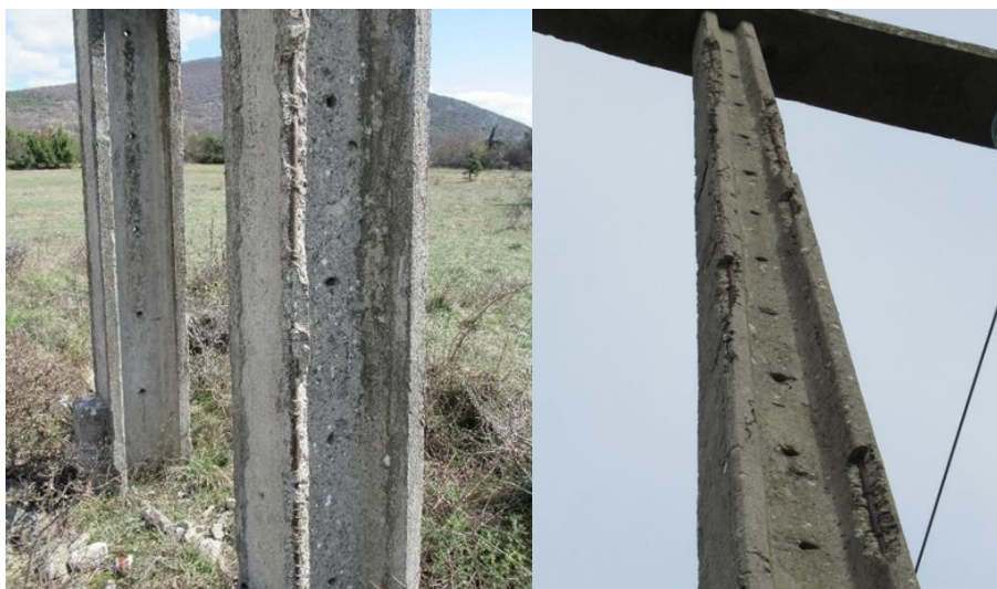
Slika 1. Oštećenja vanjskog sloja armiranobetonske konstrukcije
