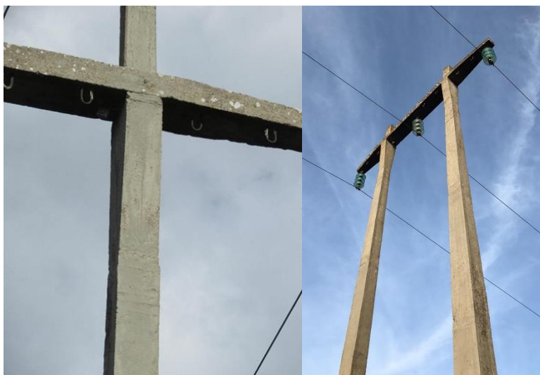
Slika 2. Stanje stupova dvadeset pet godina nakon sanacije
