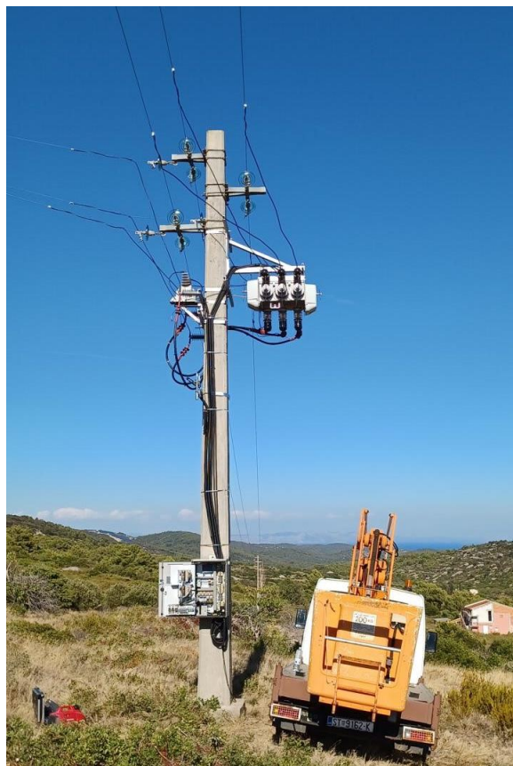
Slika 5. Dvostruka sklopka na betonskom stupu
